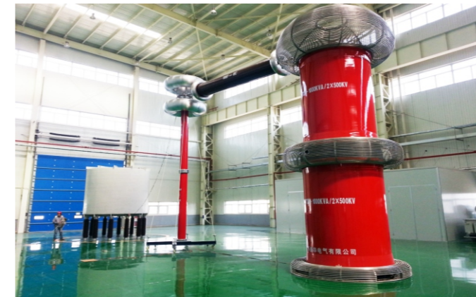
1000kV Hi-Pot Transformer
