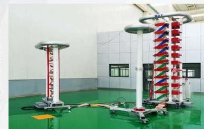
1000kV Impulse Generator
